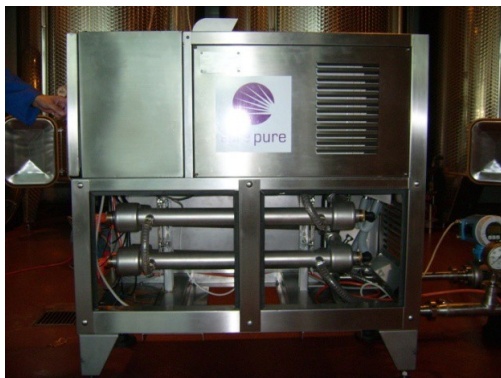
Figure N°3 : vue de profil des « Turbulateur » du Stérilisateur UV - SP4
