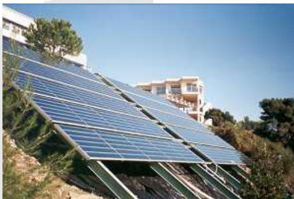
Panneaux photovoltaïques (source : Tecsol)
