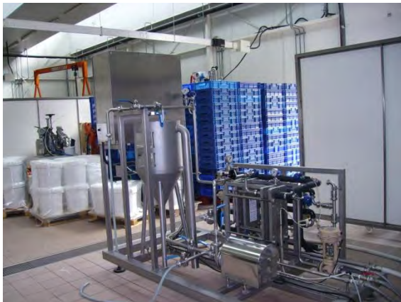
Photo 15: Equipement de flash pasteurisation Agir Pessac
