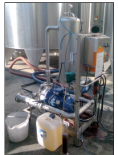
Flottation : unité de saturation.
