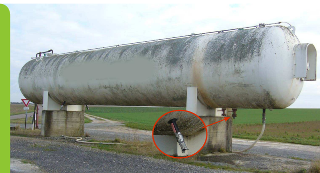
Cuve intermédiaire collective de Bussy-le-Château.
