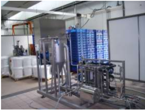
Photo 13 : Equipement de flash pasteurisation Agir Pessac
