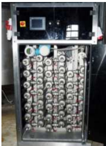
Photo 15 : Stabilisation à Froid par UV-C
