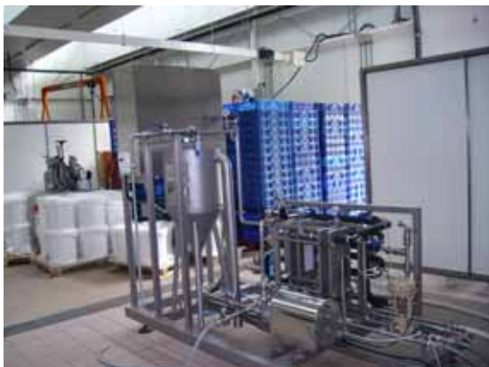
Photo 15 : Equipement de flash pasteurisation Agir Pessac
